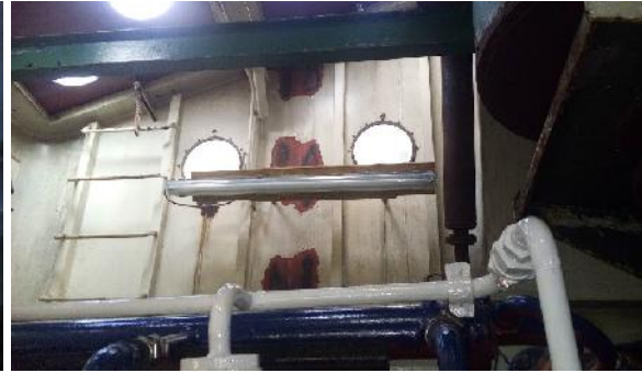
de 220 volt tl-verlichting in de machinekamer
