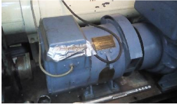
De generator op de sb-samofa
